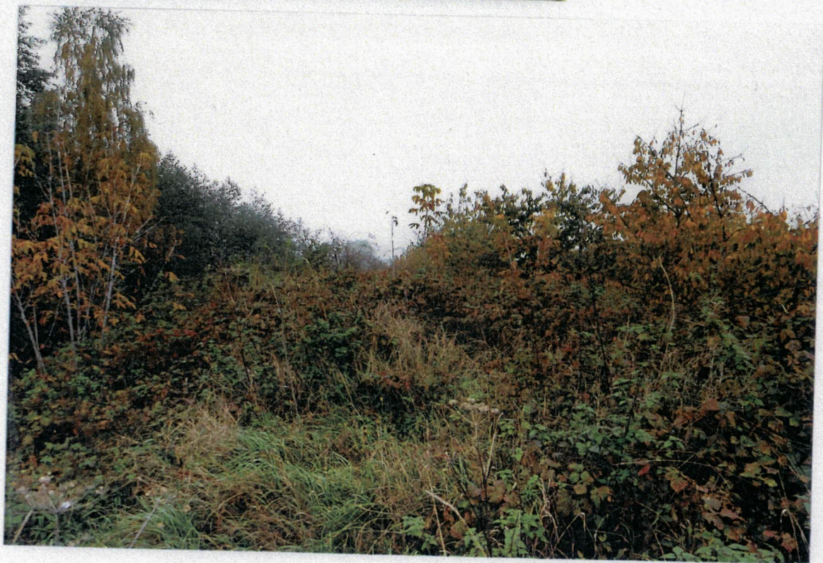
Fot. 12. Wał prawy. PX km 0+800. Zarośnięty korpus wału.
