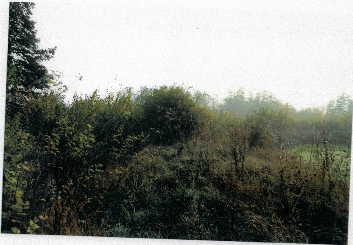
Fot. 7. Krzewy rosnące na wale lewym w km 3+450 ÷ 3+500. (PV)
