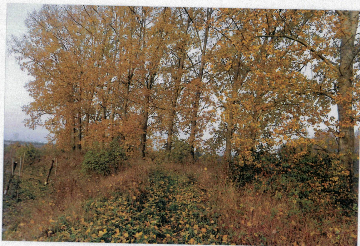
Fot. 6. Drzewa rosnące na i przy korpucie wału lewego. PV, km 3+450.
